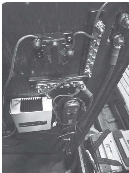
Elinstallationer monterades i den lilla garderoben på babords sida. Kablar från Skyllermarks, väldigt lätta att jobba med trots anseelig tjocklek. Regulator till solcell, batteriladdare 220 V från Exide. Batterierna står på en platta av lackad plywood direkt över bakkant på kölen.
